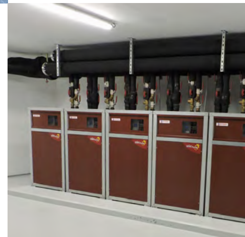
Pompe à chaleur eau-eau
