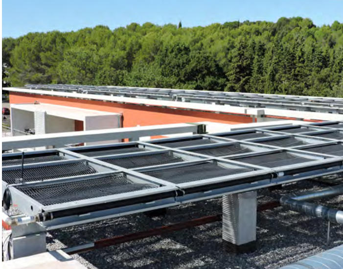
Système de production chaud-froid en toiture
