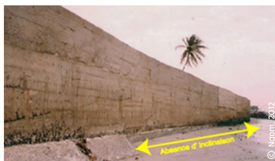
Mur en béton de Diokoul à Rufisque avec une portion sans inclinaison
