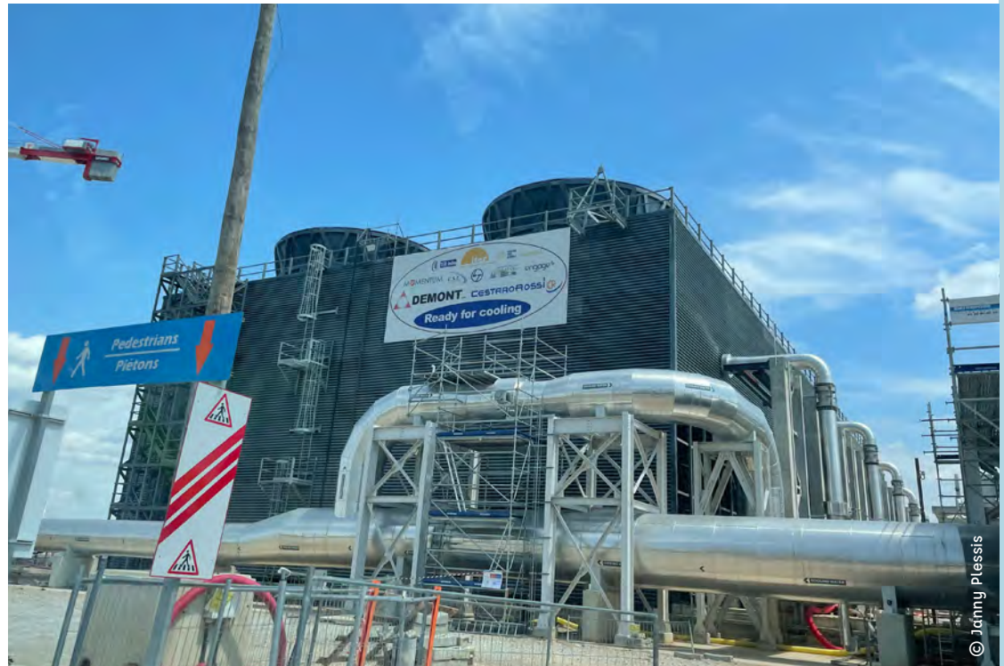
Unité d'évacuation de la chaleur, d'une capacité de l'ordre du gigawatt
