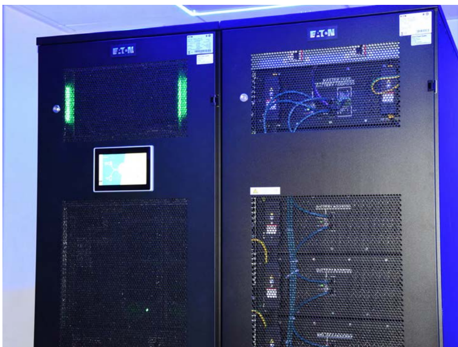
Batterie de stockage permettant d'optimiser la gestion d'énergie (© Emmanuel Maumon)
